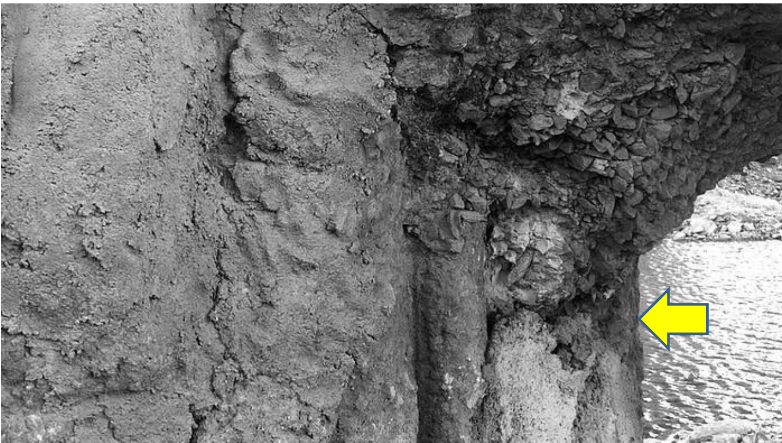
墩身与桩基接头病害
