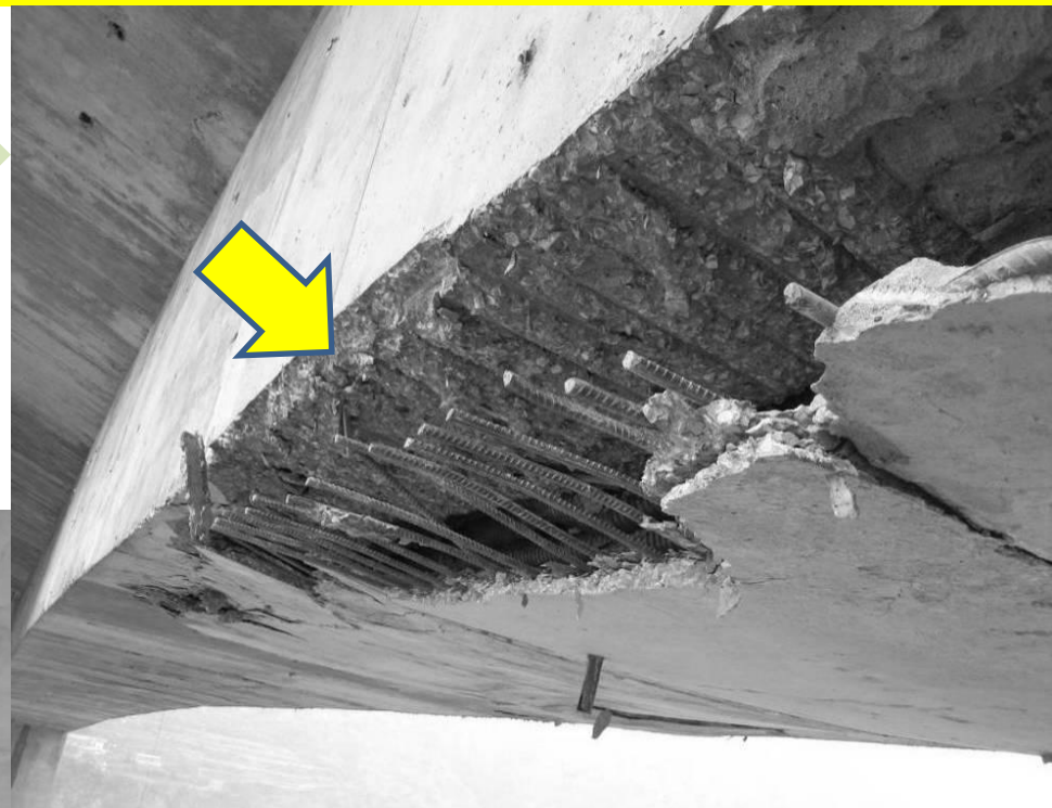
底板边缘拉裂
