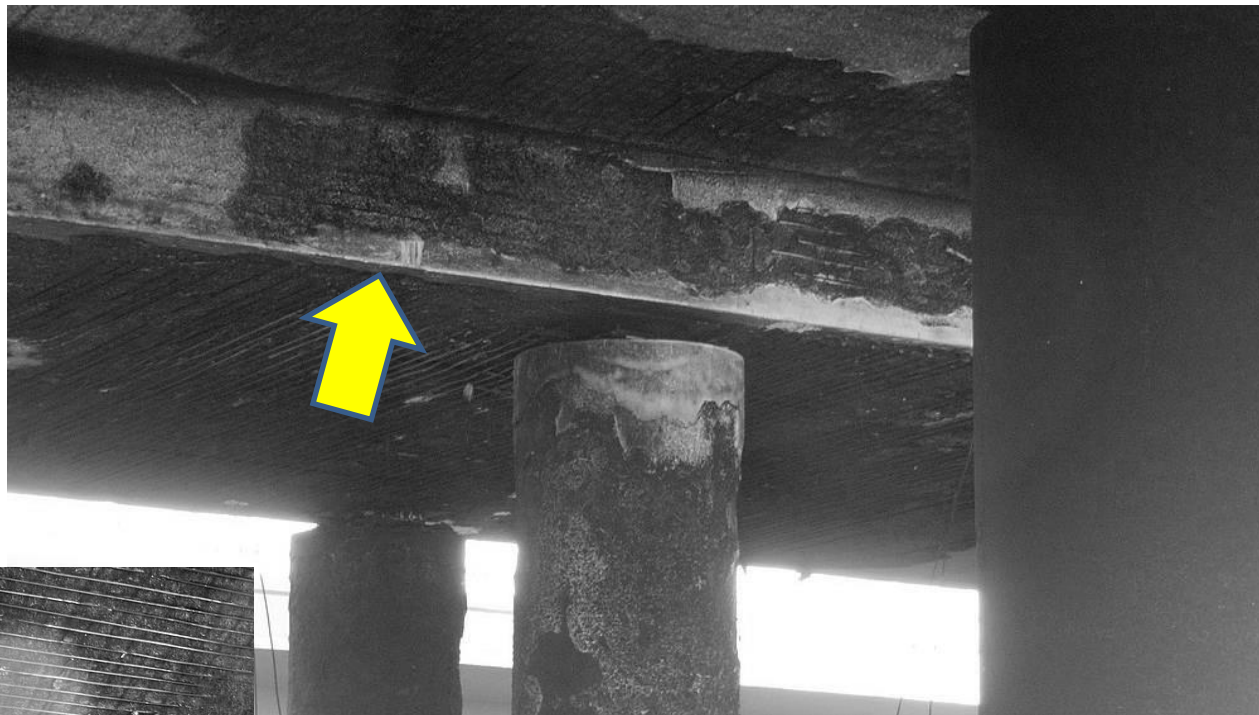
火灾后的箱梁与桥墩
