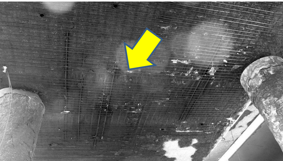
火灾后的箱梁底板
