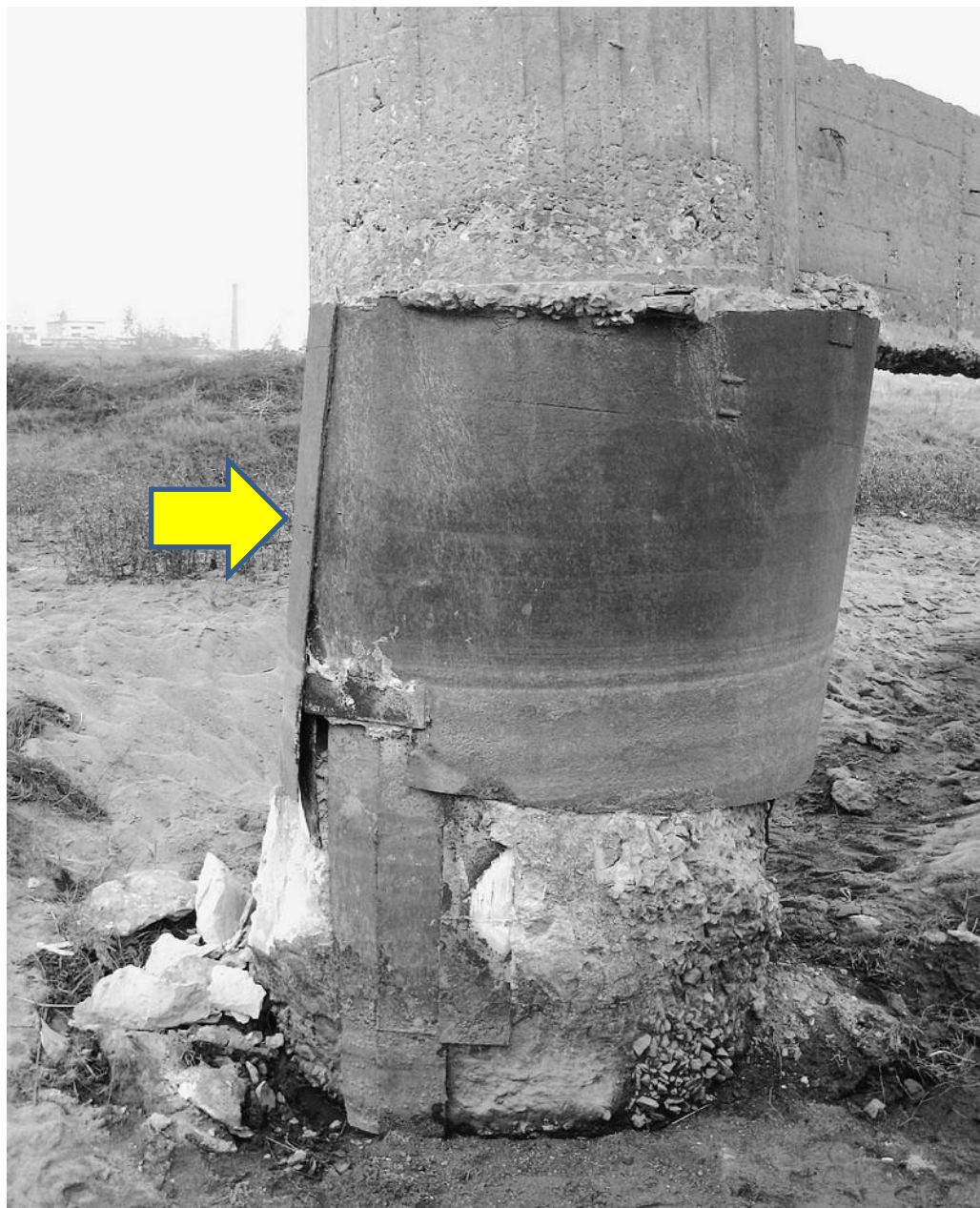
桥墩与基础接头处病害
