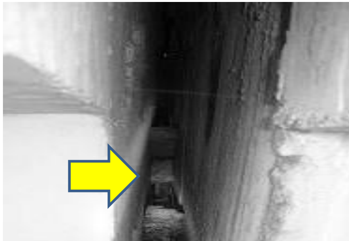
4号墩伸缩缝处夹杂混凝土
